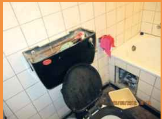
A broken toilet
